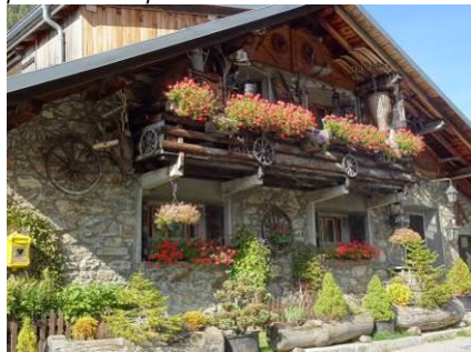
Le décroutage de l'enduit, les joints au ciment
