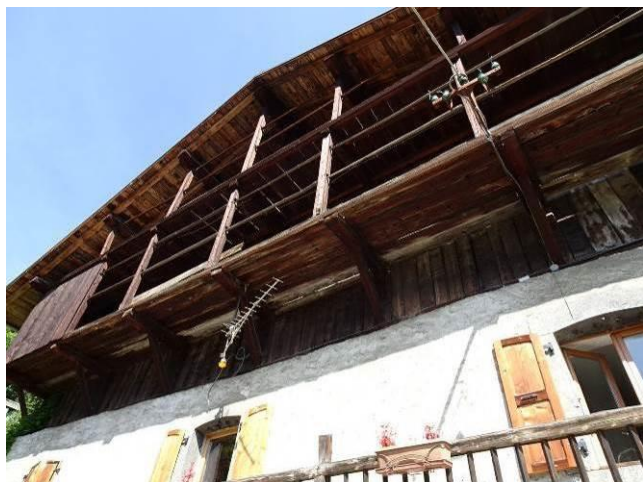
Galleries sans garde-corps Servoz_La Côte_ch Vieille route-526_p3201-
