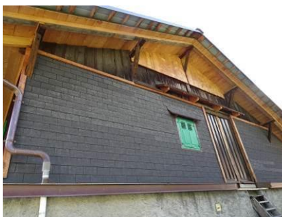
Les matériaux inadaptés : bardages divers, banalisant
